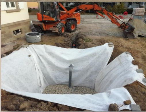
Bac dégraisseur et fosse de drainage des eaux de pluie
